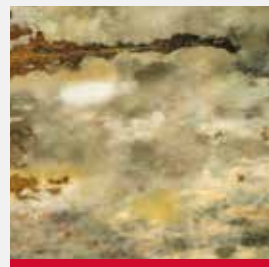
HONGOS Y MOHO
